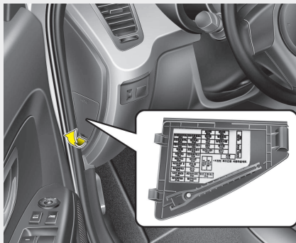
Painel de fusíveis interior
