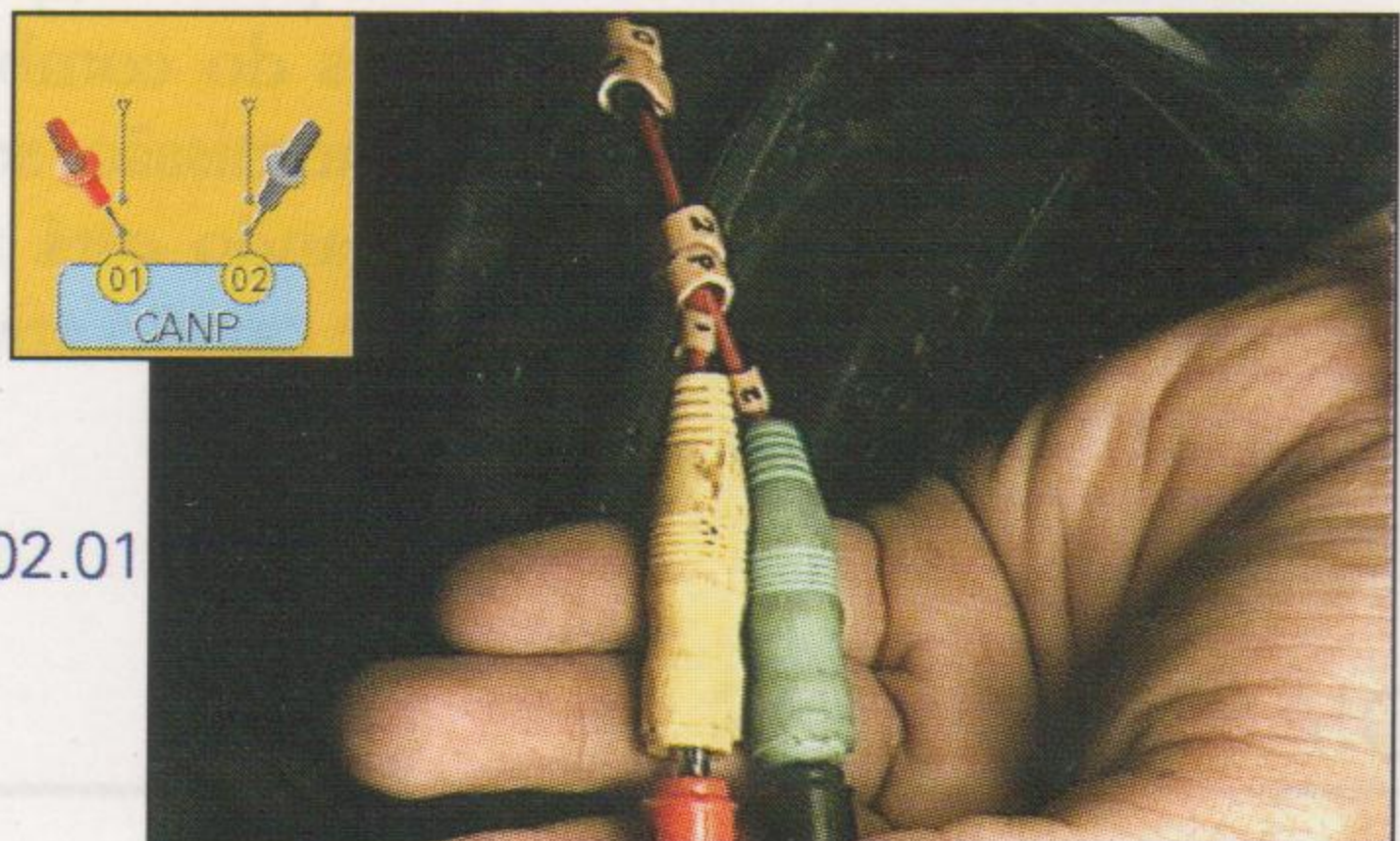
F.02.01. Medida da resistência da eletroválvula CANP.
