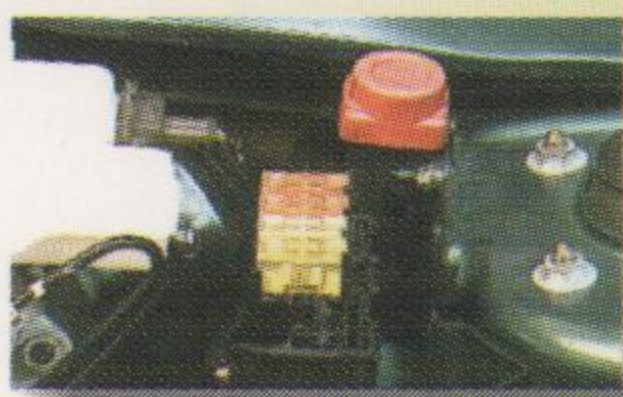
Caixa de fusíveis 02
